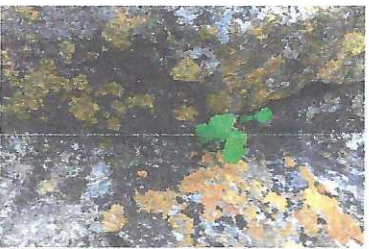
Fig. 19 détail du soubassement de l'ébrasement dextre. Présence d'une plante.
