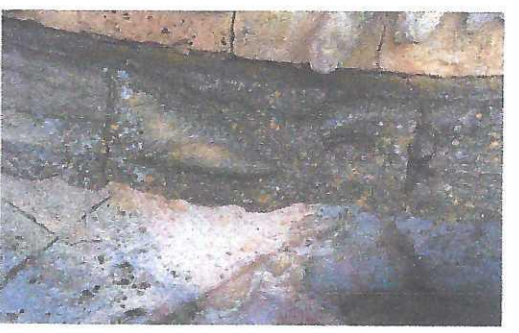
Fig. 22 détail de l'archivolte. Présence de lichens qui recouvrent l'ensemble de l'archivolte.
