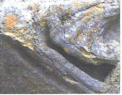
Fig. 10 détail de l'ébrasement droite. Présence de fissures.
