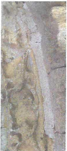
Fig.1 détail de la voussure II. Mortier de chaux et de plâtre non adhérent, fragmentaire et lacunaire.
