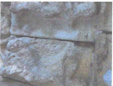
Fig. 2 détail de la voussure II. Joints ouverts.
