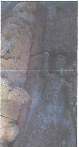
Fig. 18 détail de l'intrados de l'archivolte. Présence d'une coloration rose du calcaire.
