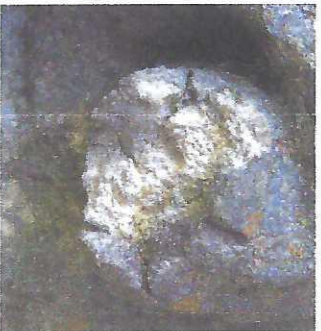
Fig. 12 détail de l'ébrasement droite. Manque de cohésion et desquamation de la pierre.
