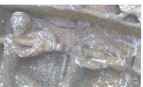
Fig. 9 détail de la voussure II. Mortier de chaux qui présente un aspect proche de celui de la pierre.
