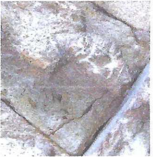
Fig. 11 détail d'un claveau de la voussure IV. Présence d'une fissure.
